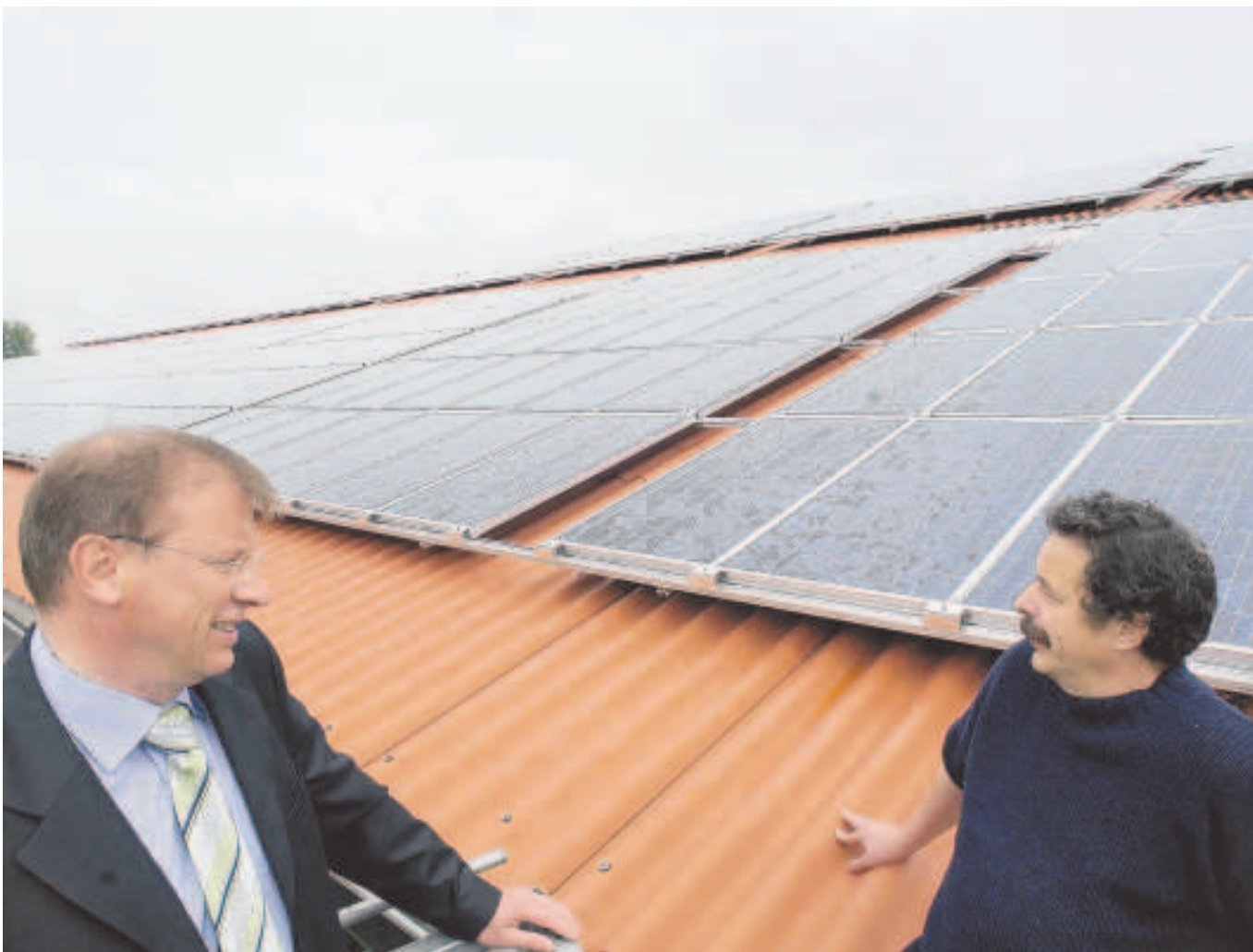
Stadtwerkechef Manfred Pusdrowski und Arno Eckert (rechts) hoffen auf Sonnenschein. Dann produziert die Solaranlage ganz viel Strom.
